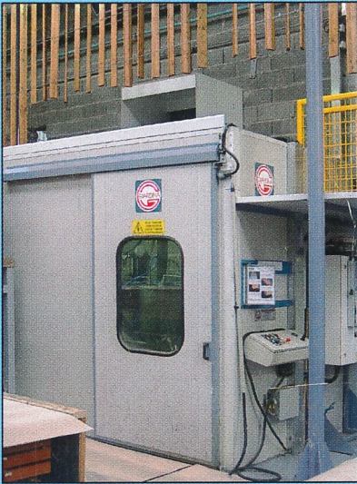
Abb.11 -Raum für elektrostatisches Gerät und Lackbehälter
