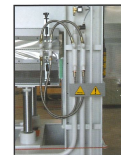
Impianto di riscaldamento Heating system Heizkreisanschlüsse
