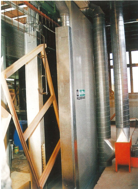
Einlauf in die Flutlackieranlage
