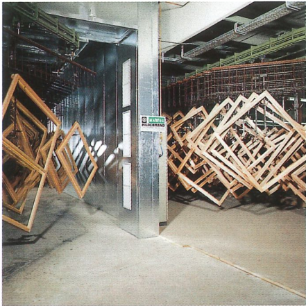
Stauraum vor dem Fluten (rechts) und Einlauf in den Lacktrockner
