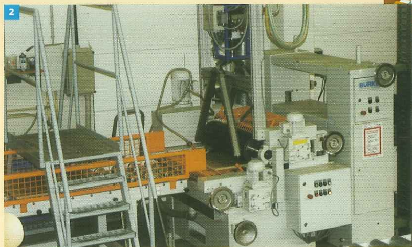
Querbürstmaschine und Leimauftragmaschine Transverse brushing machine and glue spreading machine.
