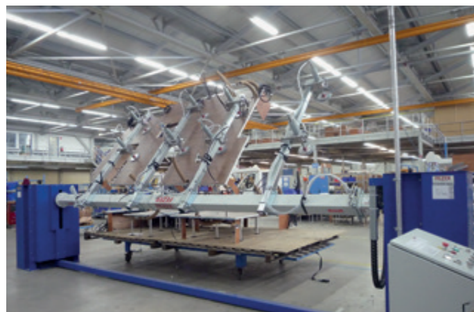
Wendestation SWS-180E-HV-200KG mit Höhenverstellung für das Wenden von Sandwichelementen in der Vormontage
