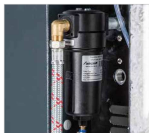
· Feinfilter als Filter vor der Druckluftentnahme zum Abscheiden von Kondensat und festen Verunreinigungen mit Partikeln bis 1 µm · Druckluftqualität nach ISO 8573-1
