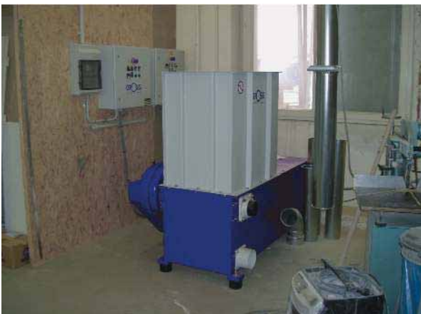
GAZ 62 Installation an eine Absaugung
