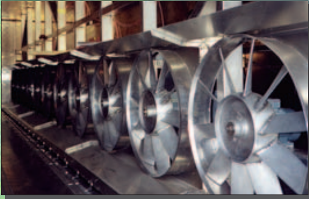
Spezialventilatoren 100 cm Durchmesser für optimierte Dampfführung und höchste „Transportleistung“ bei geringem Stromverbrauch – zwischen den Stapelreihen angeordnet
