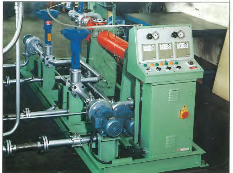
Impianto di riscaldamento con scambiatore di calore, pompe di circolazione e valvole di regolazione. Heating unit with heat exchanger, circulation pumps and regulating valves. Installation de chauffage avec échangeur de chaleur, pompe de circulation et vanne de régulation. Heizungsanlage mit Wärmetaüscher, Umlaufpumpen und Regelungsventile. Equipo de recalentamiento con intercambiador de calor, bomba de circulación y válvulas de regulación.
