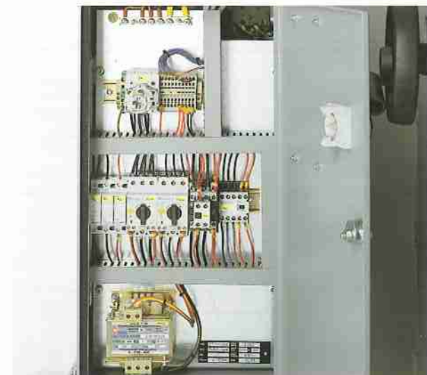
Quadro elettrico secondo le norme vigenti. Armoire électrique selon les normes en vigueur. Regulation switchboard panel. Elektrische Schalttafel nach geltenden Normen. Cuadro eléctrico conforme con la normativa vigente.
