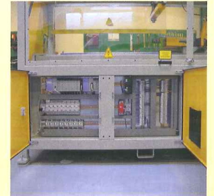
Das Steuerungssystem ist hinten in den Maschinenrahmen eingebaut, und ist hier, durch eine Tür, gegen Staub gut geschützt.
