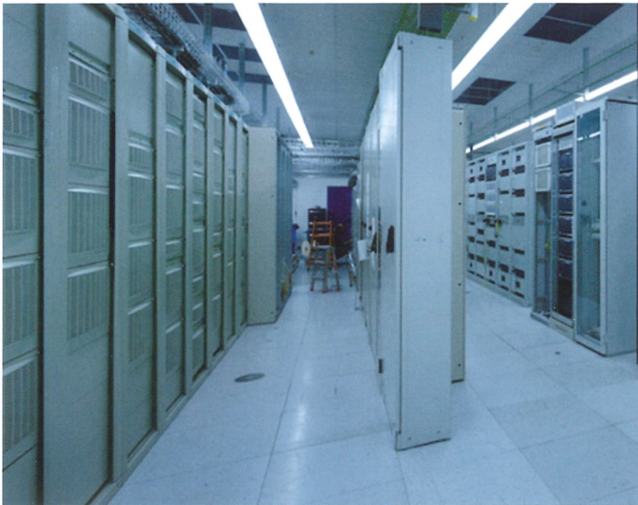
Ausfälle der Anlage werden durch Überwachung auf kritische Zustände der Energieversorgung verhindert.
