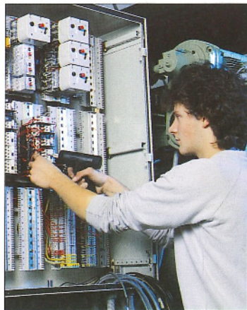
Und der Schaltschrank, das Gehirn des Profimat.
