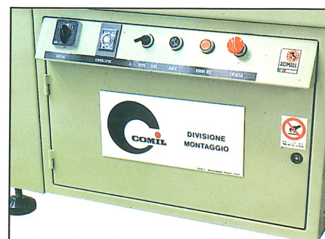
Panneau de distribution électrique.
