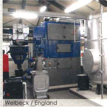
USF-W 800 als Hackschnitzelheizung mit 20 m³ Pufferspeicher
