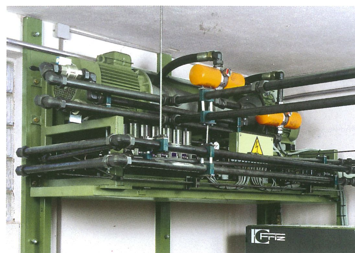
Hydraulikaggregat, ausgelegt für extrem kurze Schließ- und Druckaufbauzeiten, hier für eine Presse mit 500 N/cm 2 spez. Preßdruck.
