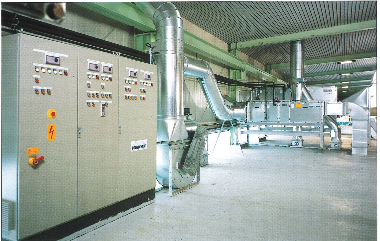
Schaltschrank zur Steuerung mehrerer Farbnebelabsauganlagen und Zuluftgeräte im Bildhintergrund
