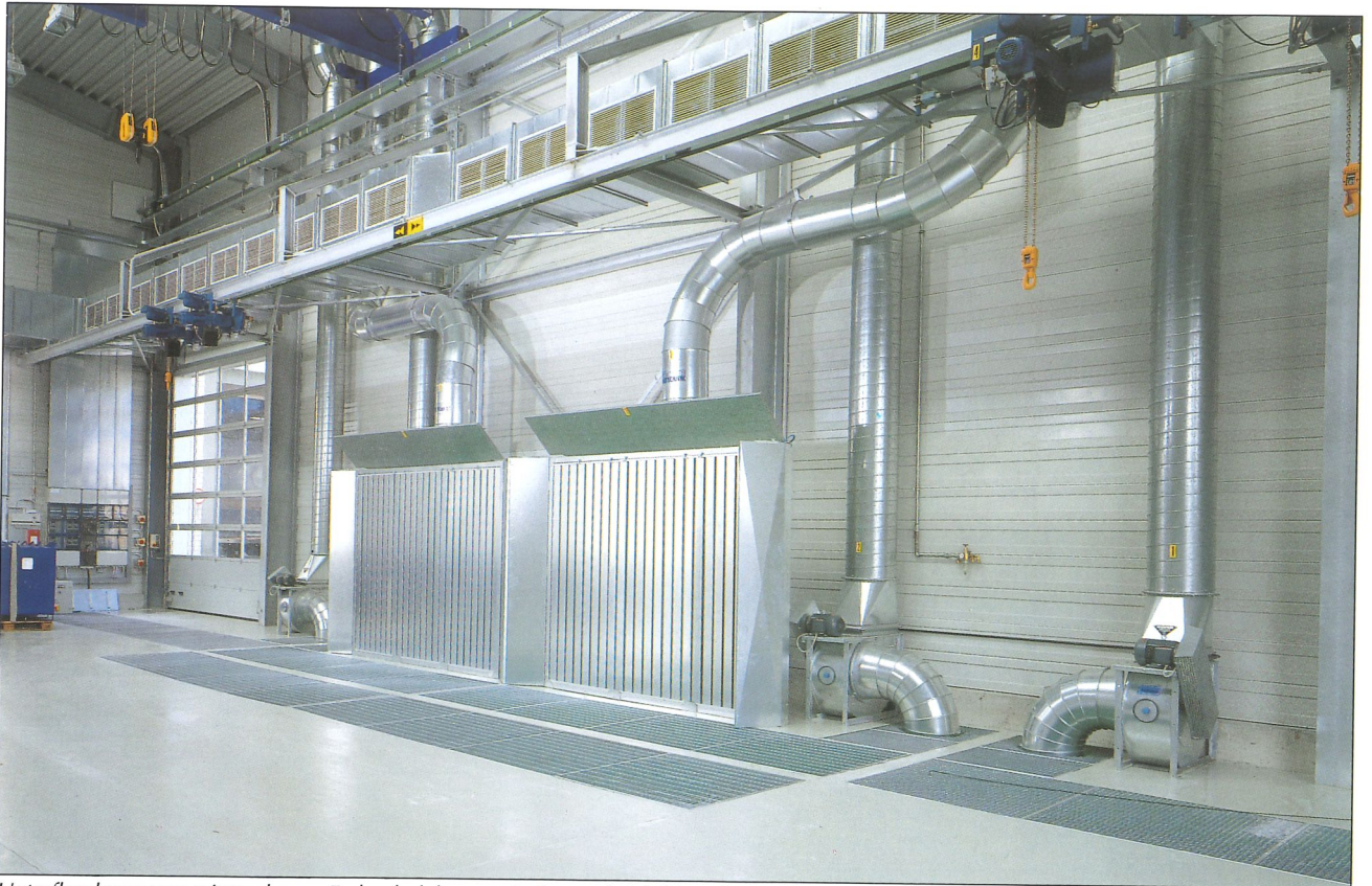
Unterflurabsaugung mit trockenen Farbnebelabsaugwänden und Zuluftkanal
