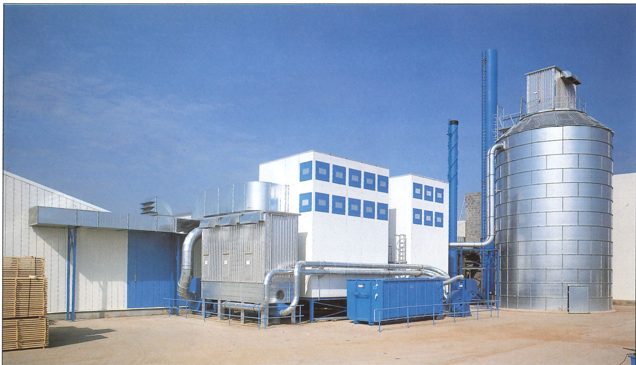
Großfilteranlage: Zwei Filterhäuser mit Luftrückführung, Transportanlage zum Silo sowie separate Filteranlage PGSQ mit Containerbeschickung für Lackschleifstaub.
