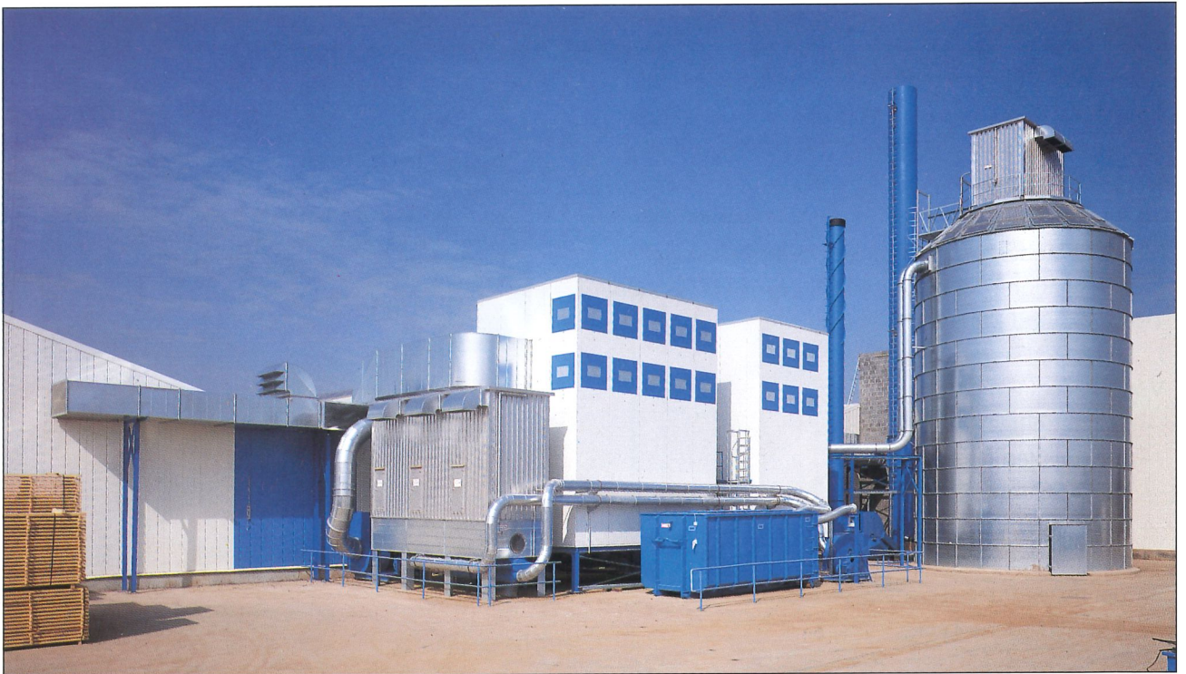
Großfilteranlage: Zwei Filterhäuser mit Lufrückführung, Transportanlage zum Silo sowie separate Filteranlage PGSQ mit Containerbeschickung für Lackschleifstaub.
