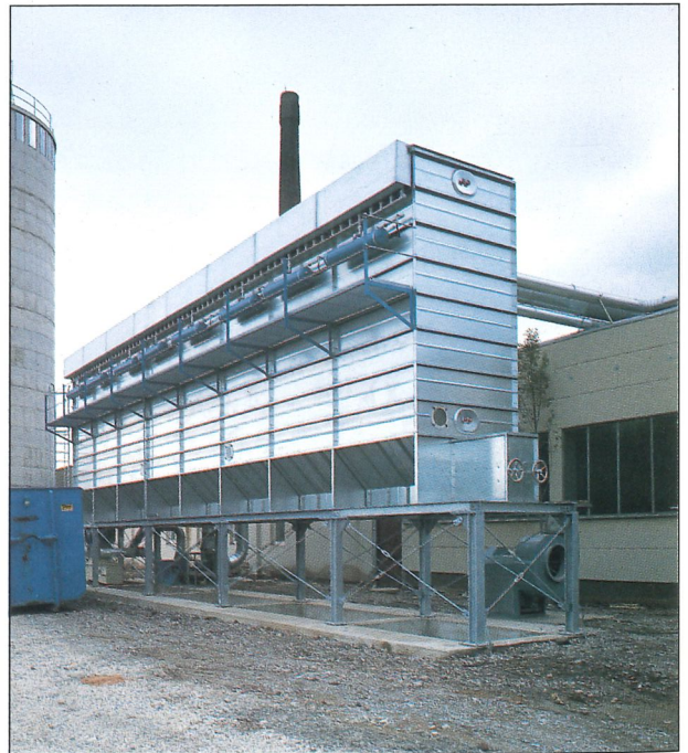
Jet-Filteranlage PVJL 2000. 850 m² Filterfläche. Unterdruckbetrieb.
