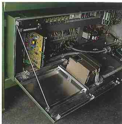
Innenansicht Schaltschrank BAS mit 4-Quadranten-Steuerung (Gleichstrom-Antrieb) und Frequenzumformer für Positioniersteuerungen.
