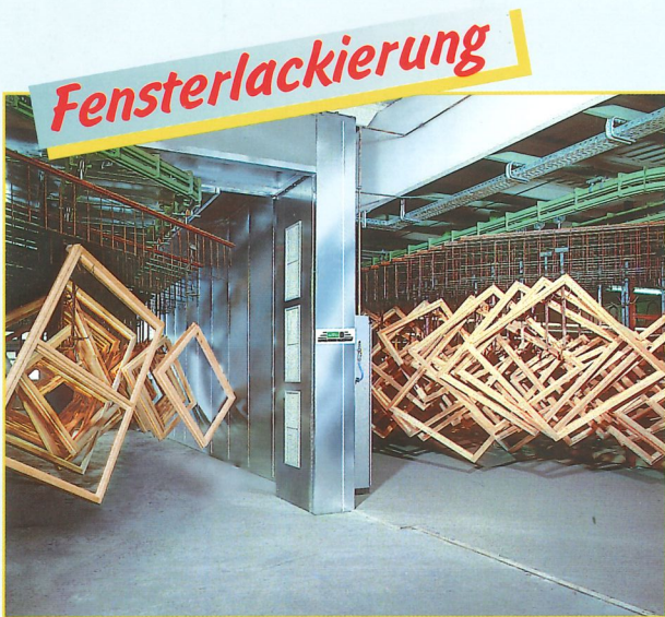
Stauraum vor dem Fluten (rechts) und Einlauf in den Lackrockner
