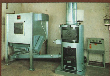
Mit der Einschubbeschickung handbeschickte Heizungen kostensparend auf Automatik umrüsten
