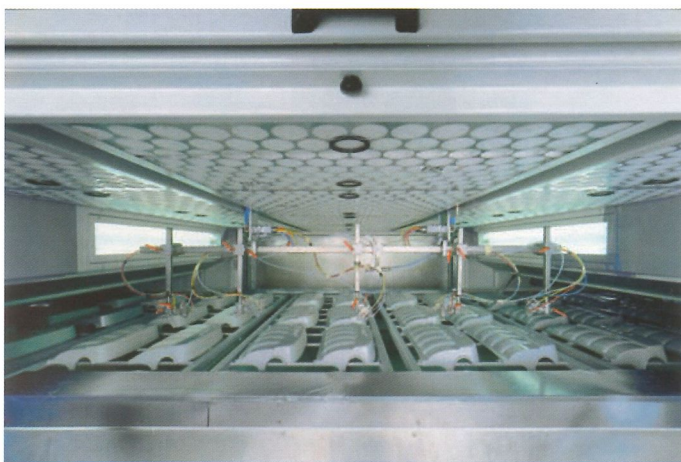
Blick in Flächenspritzlackieranlage mit Palettenförderer.
