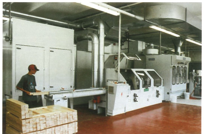
Lackierlinie für Leisten mit Glätten, Spritzen, Abstapelung und Trocknung.
