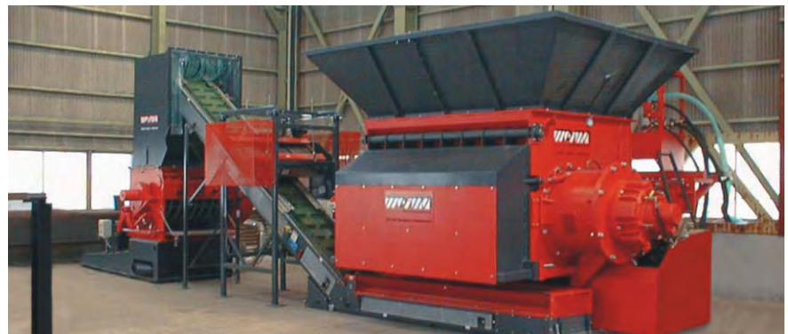
Zweistufige Zerkleinerung von Rohren / Two-stage shredding of pipes
