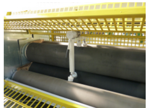
Automatische Reinigung der Walzen
