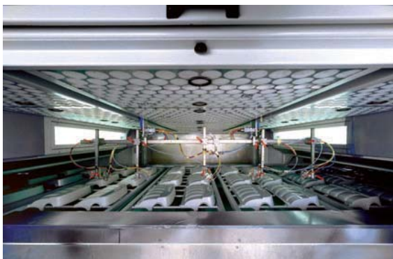
Blick in Flächenspritzlackieranlage mit Palettenförderer.
