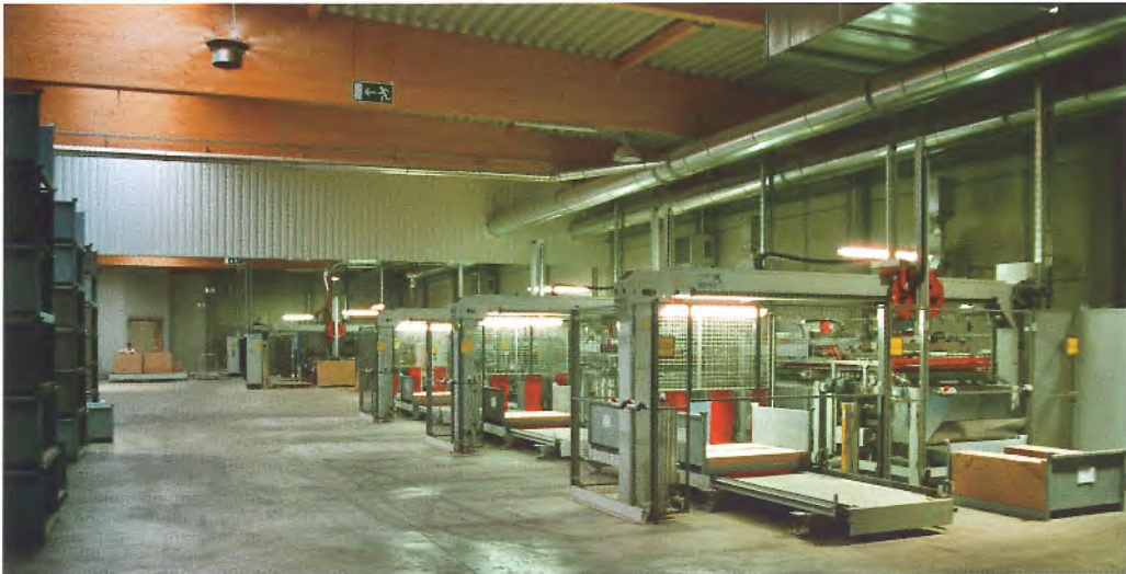
Vollautomatisches Abstapeln in Boxen Fully automatic stacking in boxes
