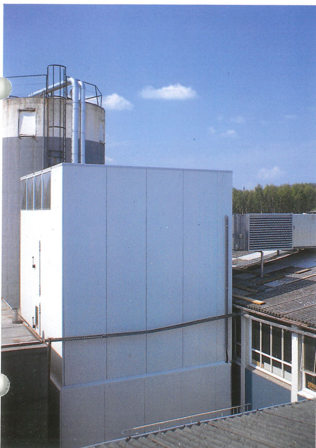
Abbildung zeigt: Nestro-Filterhaus mit Isolierverkleidung und Rückluftkanal mit Isolierung in einem Fensterwerk. Filterfläche 933 qm auf engstem Raum plaziert. Zusätzliche untere Verkleidung des Untergestells zur Schalldämmung der Absaugventilatoren, die unter dem Filterhaus aufgestellt werden. Filterhaus-Entleerung mittels Teleskop-Austragräse und Zellenradschleuse. Transportventilator und Ringleitung für druckfreie Beschickung des Spänesilos!
