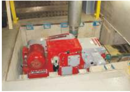
RHZ 400 S installé en fosse
