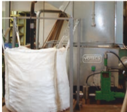
Links: Brikettierpresse AP 555 unter Filteranlage eingebaut.
