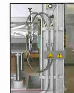
Impianto di riscaldamento Heating system Heizkreisanschlüsse
