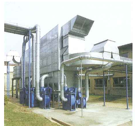
Gegendruckfilteranlage im Überdruck mit Spänetransport-ventilatoren.
