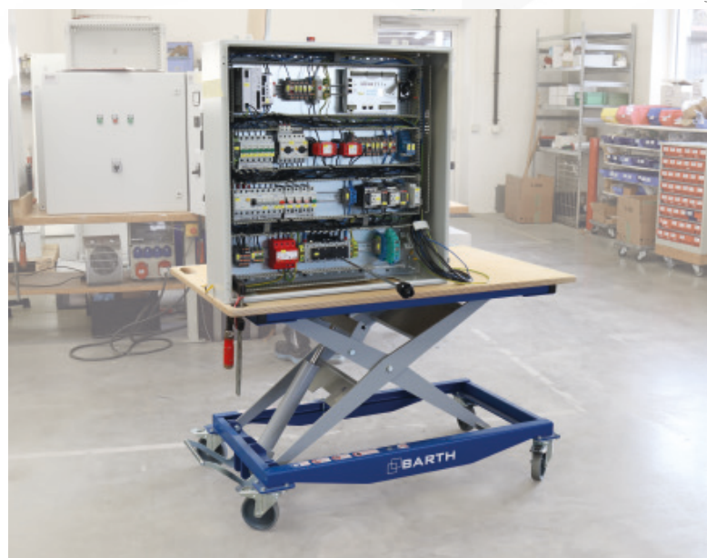
H 300 in der Schaltkastenmontage
