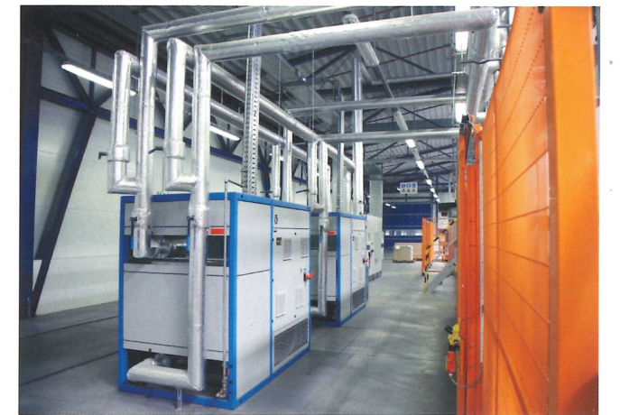
Primärheizung Primary heating
