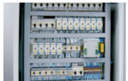
Schutzsteuerung, einfach zu warten und vielfach bewährt
