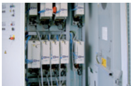
Freistehender Schaltschrank mit Kühlaggregat und separatem Frequenzwandler je Motor
