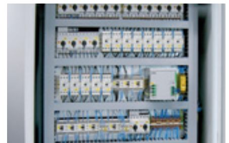
Schützsteuerung, einfach zu warten und vielfach bewährt
