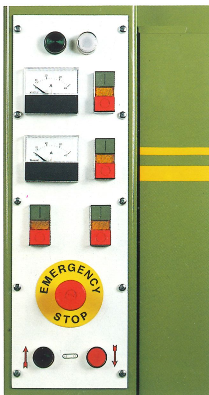
Panneau de commande électricité
