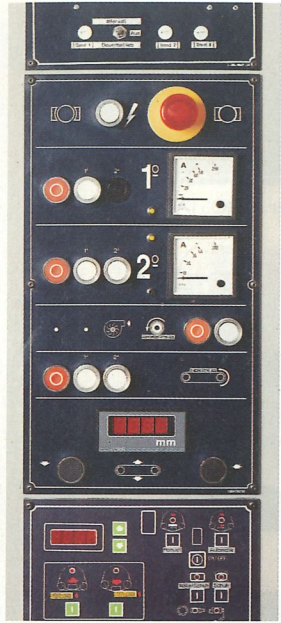
Steuerung der Doppelband-Schleifmaschine
