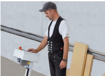
Lokales Bedienpult mit komplettem Steuersystem.
