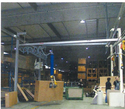
Hängebahnsystem mit selbststehender Portalkonstruktion. Arbeitsfläche: 10.000 x 4.000 mm
