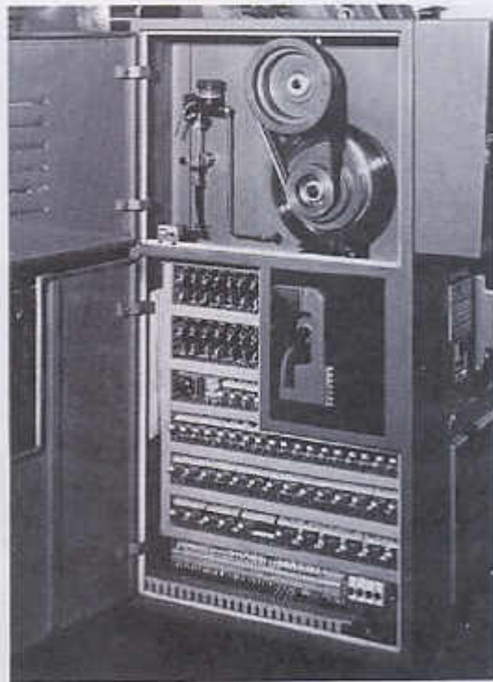
Apparecchiatura elettrica e freno Boite électrique et frein Electrical cabinet and brake Elektrische Anlage und Bremse
