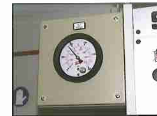
Manometro separato da quadro elettrico Pressure Gauge Manometer separat vom Schaltschrank
